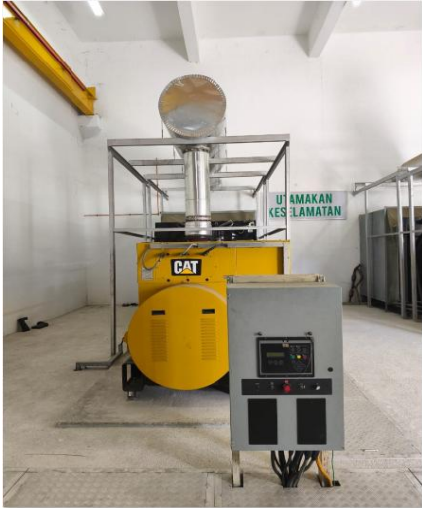
i) Generator No. 1
